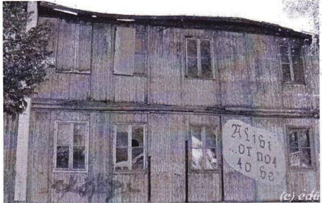
Baufällige Studentenbaracken in der Naumberger Straße (Foto: Eberhard Dürselen)
